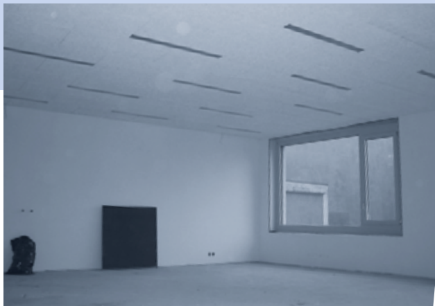
Heraklitdecke Schulzimmer mit eingelegter Beleuchtung
