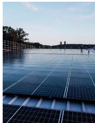
AEW Energie AG, Rheinfelden
